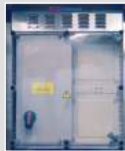
Eingangsseitiger Trennschalter zum Freischalten des Abwärtstrafo
