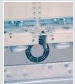
Doppelkabelverschluss mit Kabelschellen, 400V Schaltraum zwangsbelüftet
