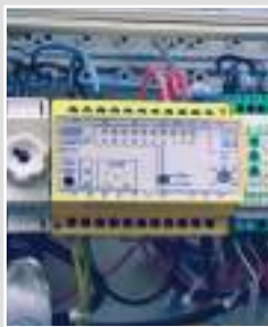
Isolationsüberwachung der 1.000V Strecke, Traforaum zwangsbelüftet
